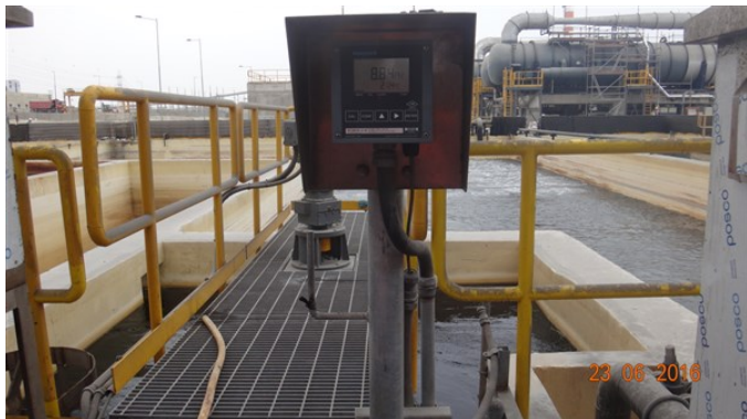
Fotografía 2. Fecha: 23 de junio de 2016 Coordenadas UTM Datum WGS84 Huso 19 Norte: 7.448.768 Este: 360.016 Descripción medio de prueba: Medidor de pH estanque de neutralización.
