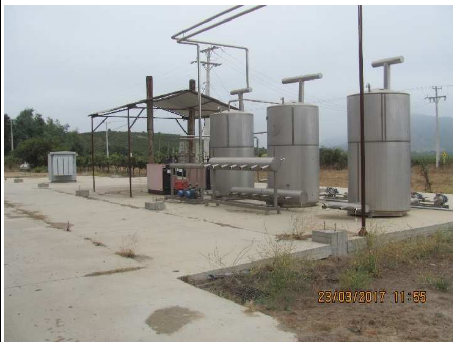
Fotografía 8. Fecha : 23 de Marzo de 2017 Coordenadas DATUM WGS84, Huso 19 Este: 285.820 m. Norte: 6.311.683 m. Descripción Medio de Prueba: Sector donde se ubican estanques de acumulación de agua caliente. Se evidencia su inactividad.
