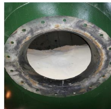
Figura 11 - Columna IO'1 con su resina nueva al interior.
