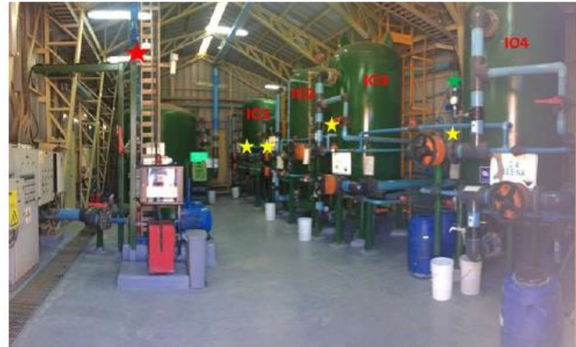
Figura 1- Visión general de la planta abatidora. Columnas de resina están indicadas. Las estrellas indican la ubicación de los flujómetros. Estrella roja (flujómetro de entrada), amarillo (flujómetros de las columnas), verde (flujómetro de salida).
