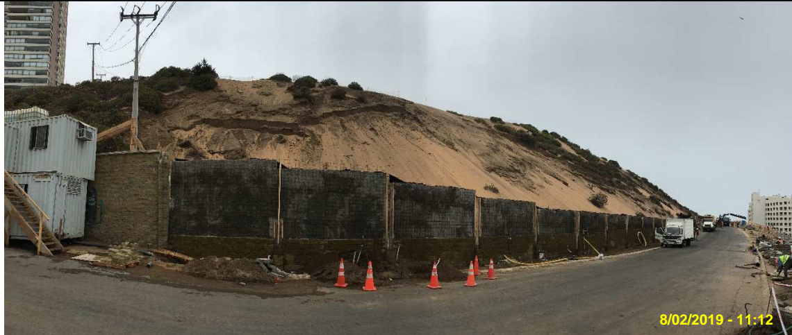
Fotografía N°1 Fecha: 8 de febrero de 2019. WGS84 Huso 19 Norte: 6.352.886 m. Este: 261.712 m. Descripción del medio de prueba: Vista de la construcción de la extensión de la calle Cornisa en el sector norte del proyecto de loteo y urbanización.
