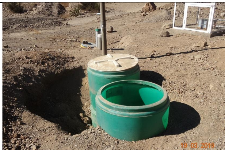
Fotografía 27. Fecha: 19-03-2019 Coordenadas UTM DATUM WGS84 HUSO 19S Norte: 6.763.435 Este: 299.003 Descripción del medio de prueba: Planta compacta de tratamiento de aguas servidas, ubicada en área de lavado.
