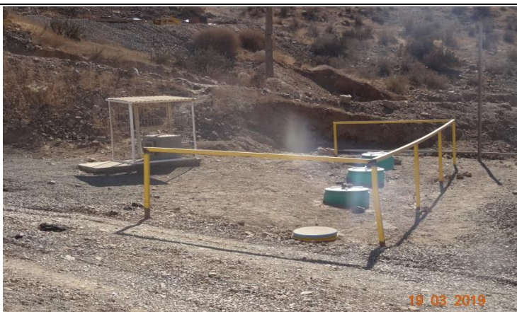
Fotografía 28. Fecha: 19-03-2019 Coordenadas UTM DATUM WGS84 HUSO 19 S Norte: 6.763.453 Este: 299.184 Descripción del medio de prueba: Planta compacta de tratamiento de aguas servidas, ubicada en área de administración (instalación de faena).
