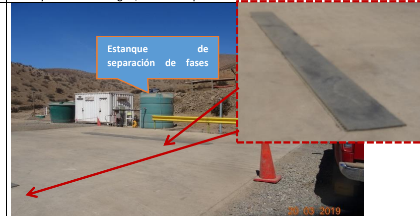
Fotografía 37. Fecha: 20-03-2019 Coordenadas UTM DATUM WGS84 HUSO 19S Norte: 6.763.466 Este: 299.002 Descripción del medio de prueba: Área de lavado de maquinaria, con una base de hormigón y 2 rejillas, las que conducen aguas del lavado hacia estanque de separación de fases y tratamiento de tipo compacto.
