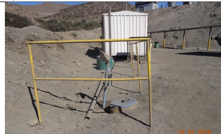
Fotografía 29. Fecha: 19-03-2019 Coordenadas UTM DATUM WGS84 HUSO 19S Norte: 6.763.573 Este: 298.709 Descripción del medio de prueba: Planta compacta de tratamiento de aguas servidas, ubicada en área de planta de tratamiento (planta de beneficio).
