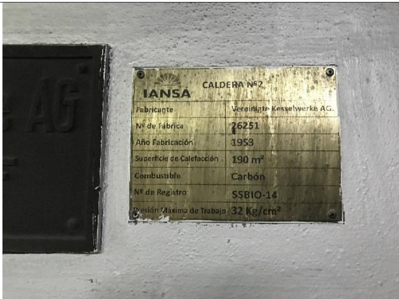
Fotografía N°2 Fecha: 23.05.2019 Descripción: Caldera N°2 Planta IANSA Los Angeles
