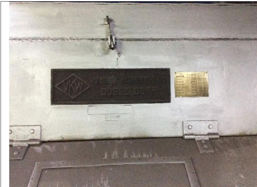
Fotografía N°1 Fecha: 23.05.2019 Descripción: Caldera N°2 Planta IANSA Los Angeles
