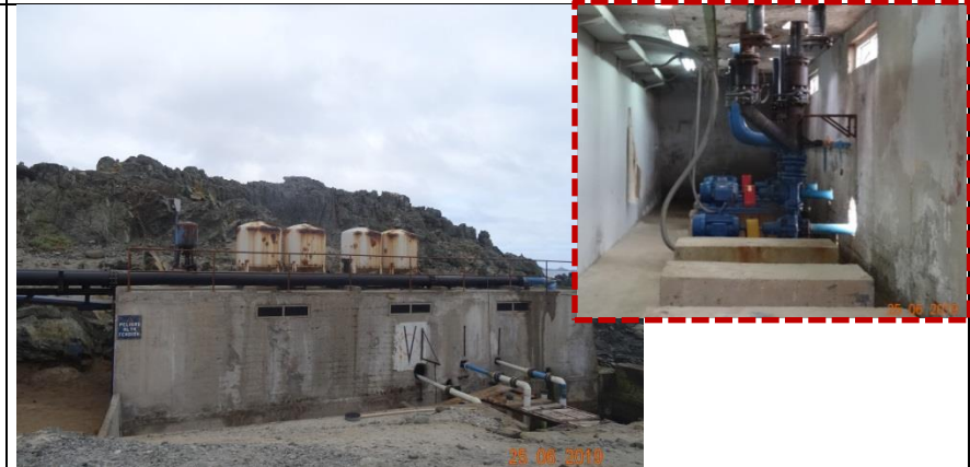
Fotografía 16. Fecha: 25-06-2019 Coordenadas UTM DATUM WGS84 HUSO 19 S Norte: 7.007.734 Este: 319.572 Descripción del medio de prueba: Área de succión de agua de mar, la cual posee un galpón donde se ubican 3 bombas aductoras (imagen superior).
