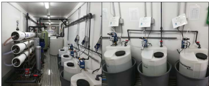
Figura 2. Interior Planta de osmosis.
