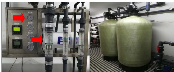
Figura 4. Manómetros y flujómetros de caudales.
