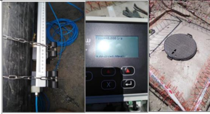
Instalación de medidor de flujo bypass PTAS Mejillones
