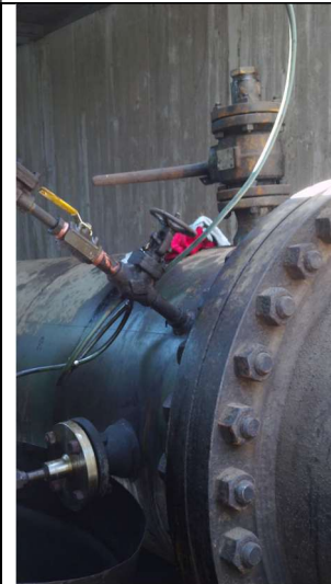
Figura N°4 Detalle de punto de inyección de aditivo secuestrante
