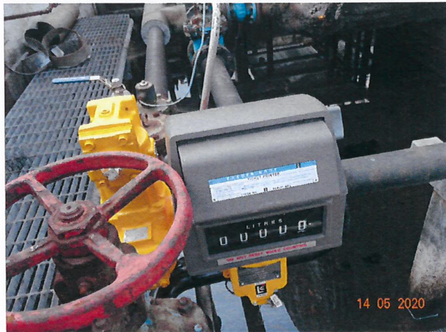
Fotografía 9: meter es estanque principal de petróleo Diesel de abastecimiento de calderas
