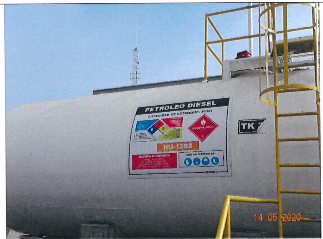
Fotografía 8: estanque principal de petróleo diésel de abastecimiento de calderas.
