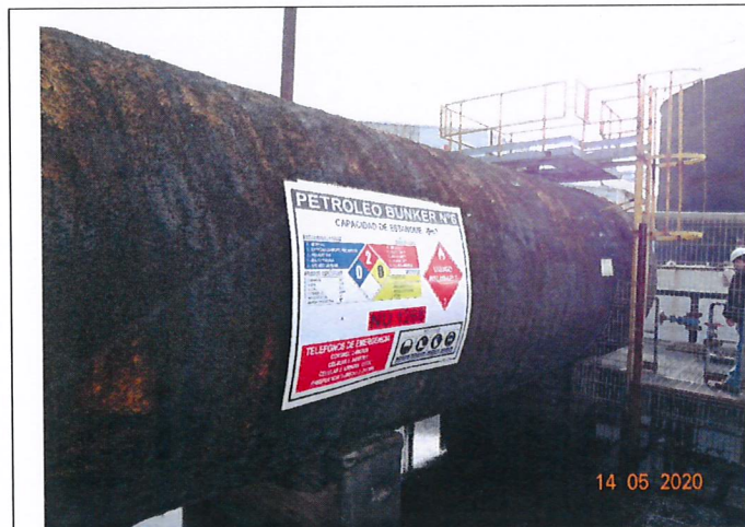
Fotografía 7: estanque principal de petróleo Bunker de abastecimiento de calderas
