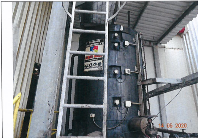
Fotografía 5: Estanque de auxiliar de abastecimiento de calderas.
