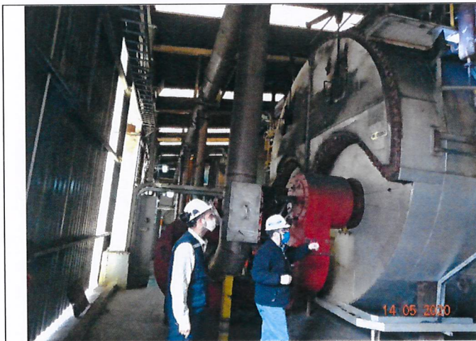
Fotografía 1: Sala de Caldera
