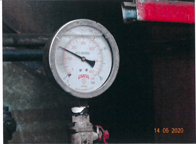
Fotografía 4: manómetro presión a la cual se estaba trabajando al momento de la inspección.
