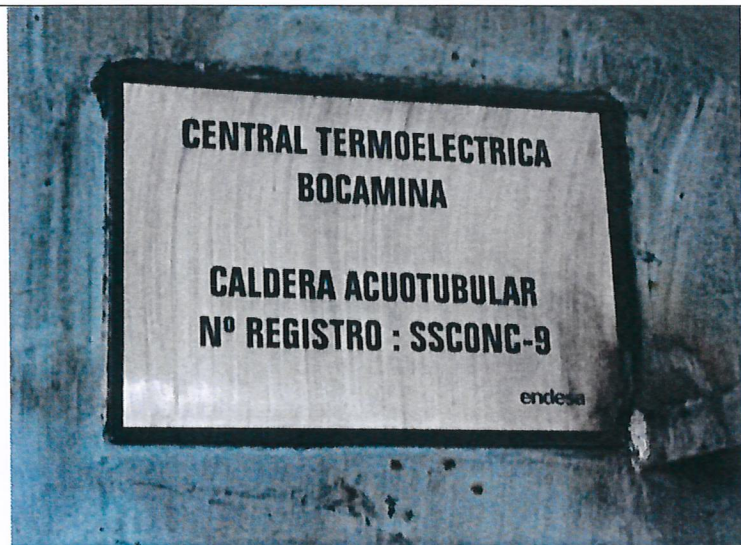
Fotografía 1: Placa de Caldera Unidad 1
