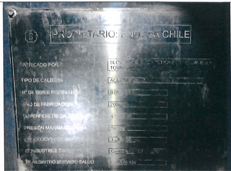
Fotografía 2: Placa de Caldera Unidad 2
