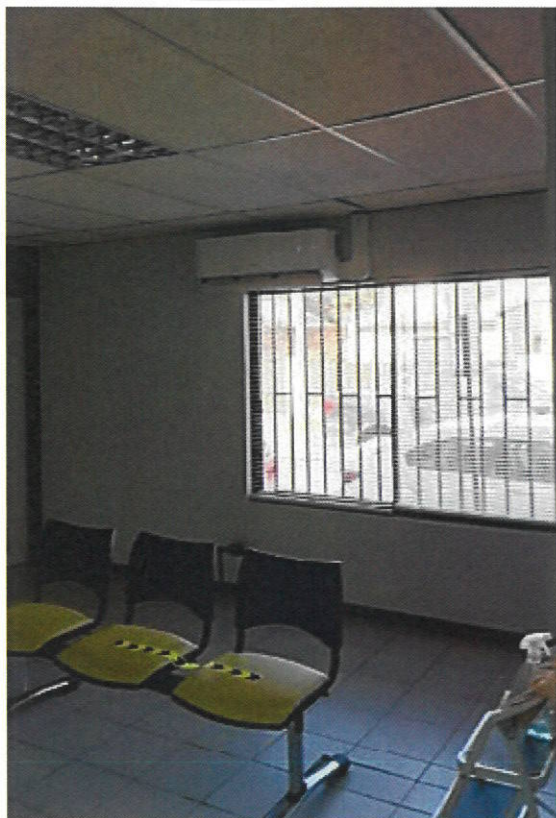
Equipo de aire acondicionado 3
