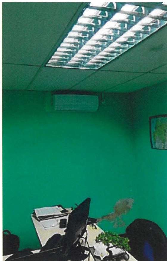
Equipo de aire acondicionado 4
