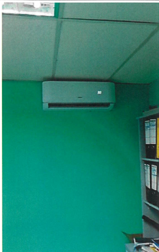
Equipo de aire acondicionado 1
