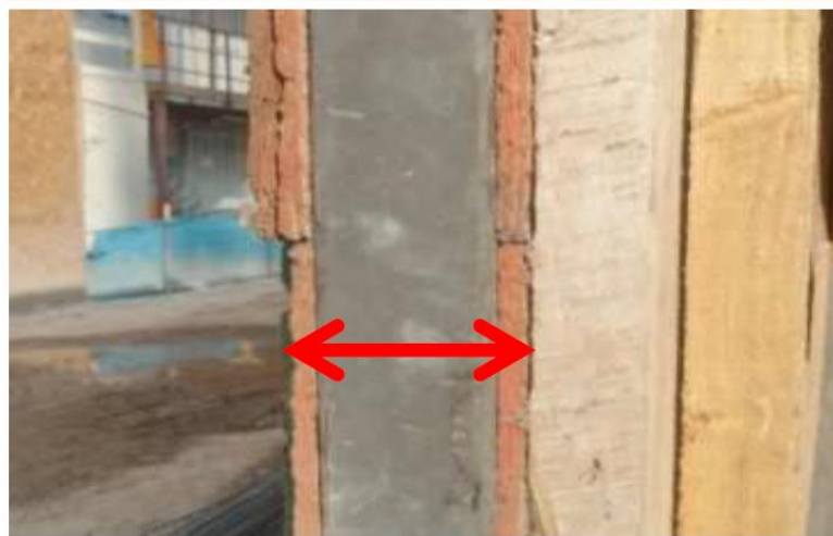
Figura 5. Encierro acústico bomba de hormigón. – Fuente: Entregado por el titular
