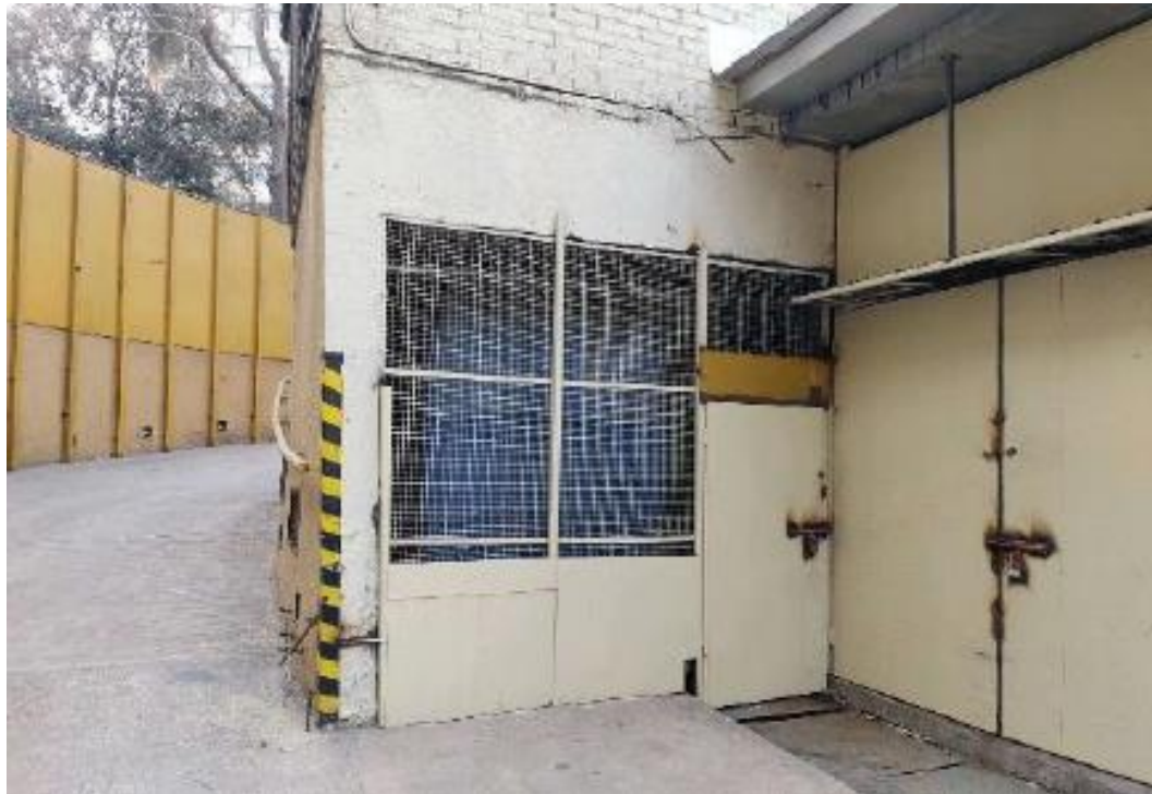
Figura 2. Fuente emisora, torre de enfriamiento, sin aislamiento acústico
