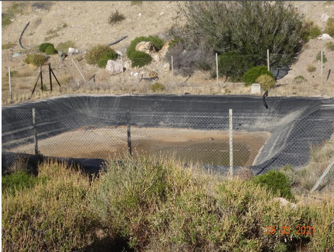
Fotografía 6 Fecha : 26-03-2021 Descripción Medio de Prueba: Las tuberías de drenaje se encuentra secas al igual que la piscina donde se reciben esta aguas.
