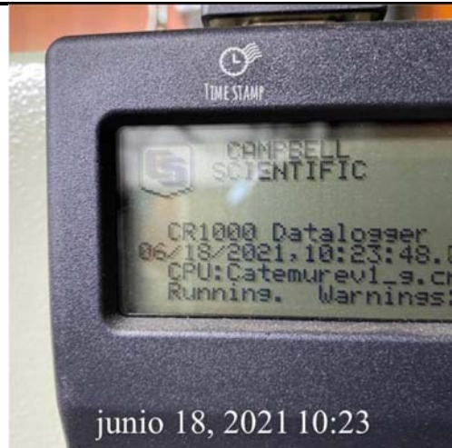
Fotografía 20 Datalogger de SO 2 en estación El Arrayán (Catemu)
