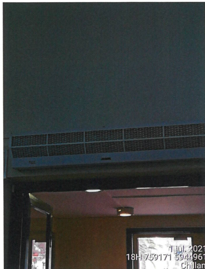
Equipo adosado a muro.
