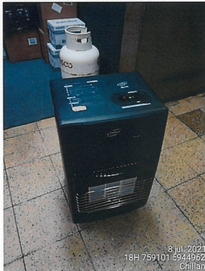
Equipo a gas de calefacción.
