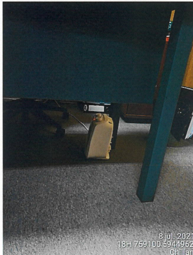
Equipo eléctrico de calefacción.
