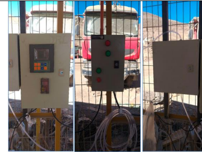
Ilustración 5: Instalación de controlador de pH, registro de pH, caja de energía eléctrica y bomba dosificadora.
