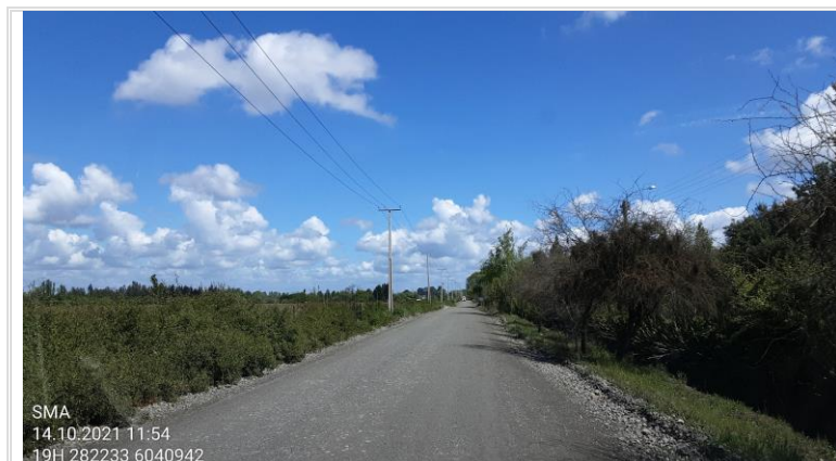
Fotografía 4. Fotografía del estado del camino Santa Ester al momento de la inspección
