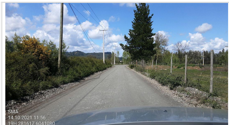
Fotografía 1. Fotografía del estado del camino Santa Ester al momento de la inspección.
