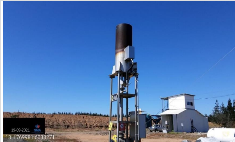
Fotografía 3. Fotografía de la antorcha captada al momento de la inspección, la cual se encontraba apagada.
