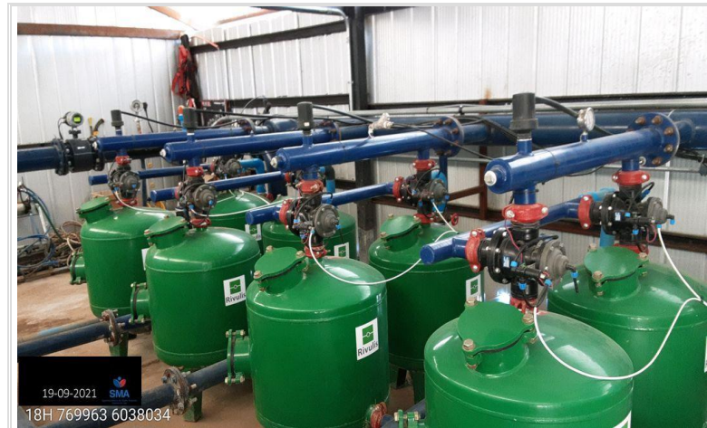
Fotografía 10. Filtros de cuarzo del sistema de riego dispuestos en la caseta de
