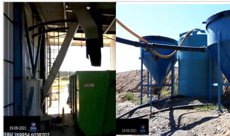
Fotografía 6. A la izquierda, sistema de recolección de digestato sólido. A la derecha, sistema de recolección y pretratamiento de digestato líquido.
