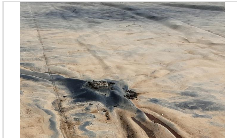
Fotografía 8. Fotografía de uno de los escapes de gas con filtro de carbón activado, dispuesto en la laguna de acumulación de digestato.
