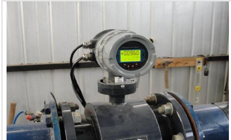
Fotografía 14. Caudalímetro al interior de caseta de riego.
