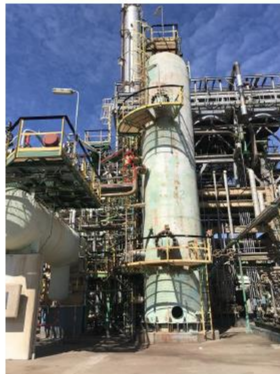
Figura 13: Drenaje medidor de nivel F-702
