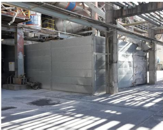
Figura 7. Paneles aislación acústica sistema sopladores válvula descarga recirculación sólidos de ciclón caldera
