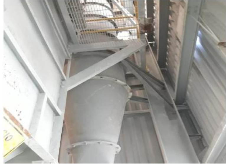
Figura 6. Silenciador ducto descarga planta caliza
