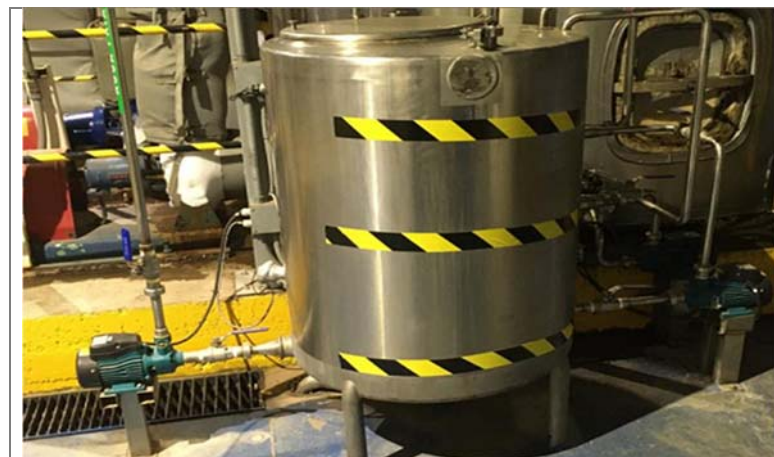
Fotografía 10. Fotografía en primer plano de la instalación de sistema de acumulación y bombeo asociado a cumplimiento de la Acción N.º 4, remitido por el titular en el Reporte de Cumplimiento 2.
