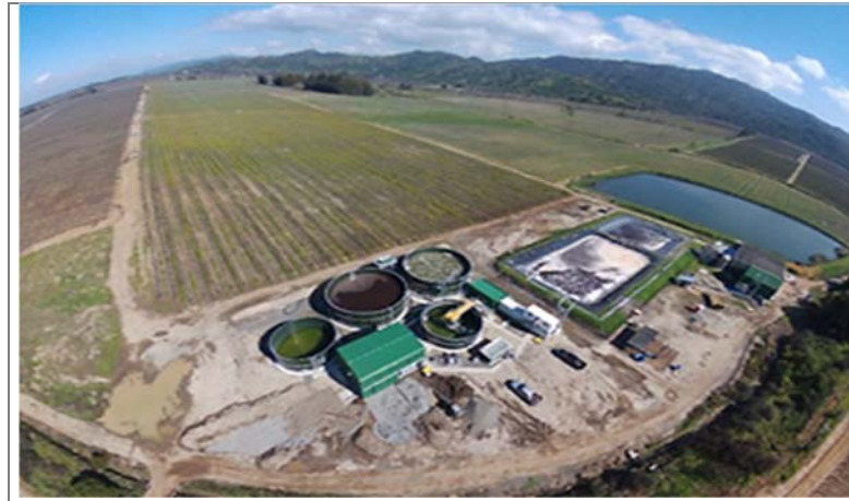
Fotografía 6. Fotografía aérea de la planta de tratamiento de RILes de la unidad fiscalizable, con las modificaciones efectuadas por el titular.
