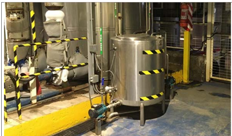
Fotografía 9. Fotografía general de la instalación de sistema de acumulación y bombeo asociado a cumplimiento de la Acción N.º 4, remitido por el titular en el Reporte de Cumplimiento 2.
