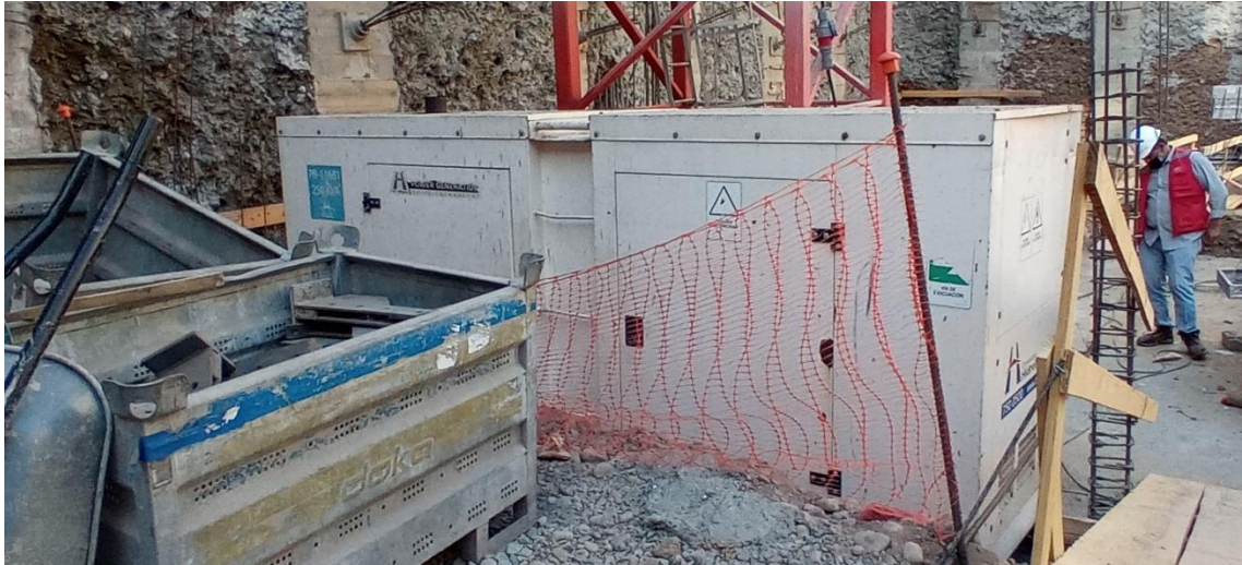
Figura 9. Grupo electrógeno posición original.
