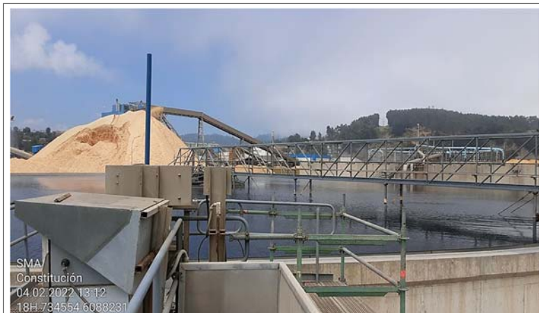
Fotografía 3. Fotografía del sistema de tratamiento de RILes, específicamente del clarificador secundario, última etapa del sistema.
