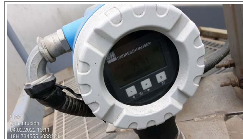
Fotografía 4. Fotografía del caudalímetro ubicado a la salida del clarificador secundario.
