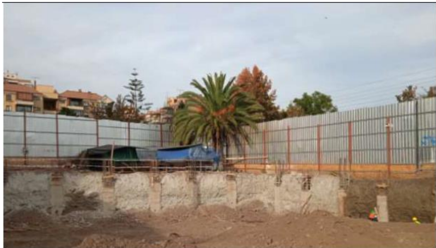
Figura 1. Cierre acústico perimetral.
