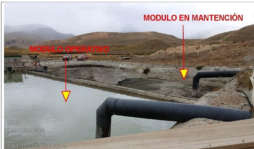
Fotografía 8. Fotografía de las piscinas de decantación, correspondiente a módulos C y D. Como se puede observar el módulo C se encontraba en mantención.
