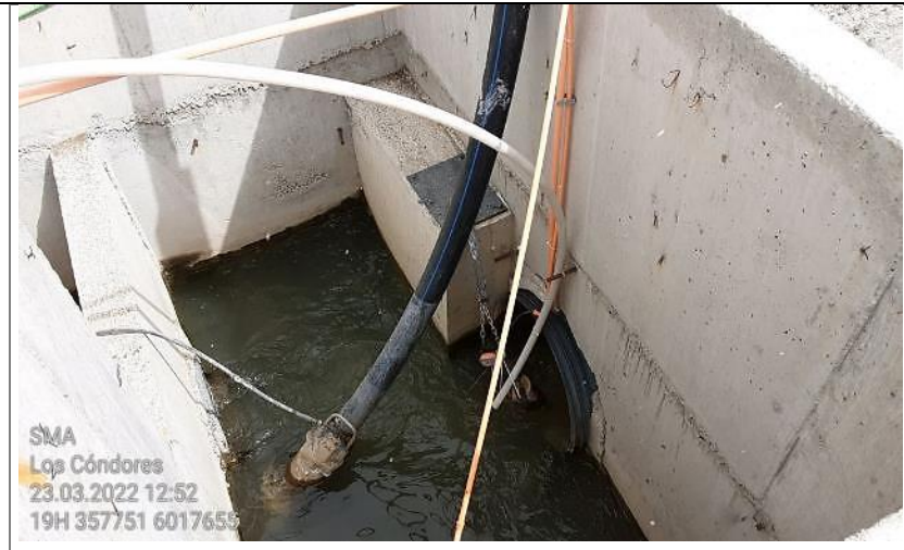
Fotografía 11. Fotografía de la última cámara previa a la descarga de RIL en sector Lo Aguirre.
