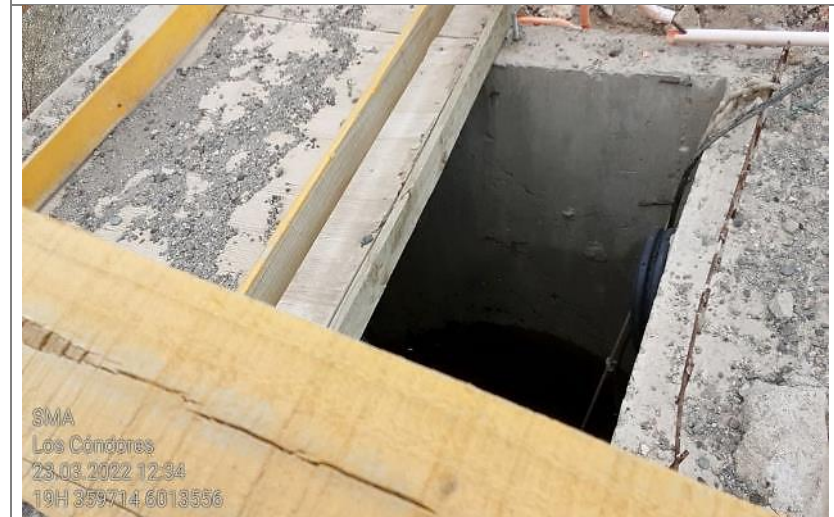
Fotografía 4. Fotografía de la última cámara previa a la descarga de RIL en sector Pique de Válvulas.
