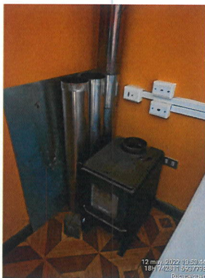
Foto 5 – equipo a leña desinstalado y fuera de operación.
