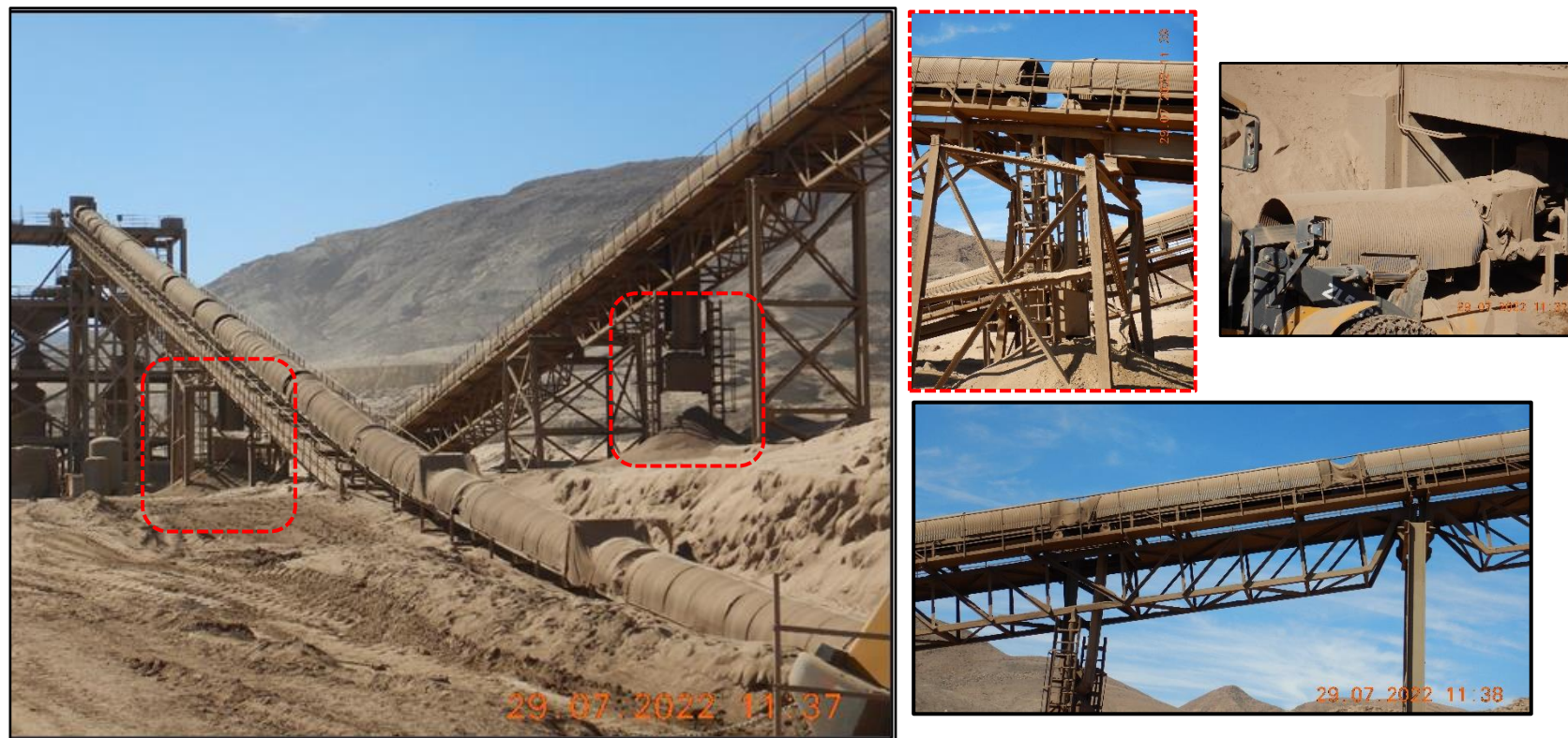
Fotografía 8. Correas transportadoras entre Chancador 2° y Harnero Vibratorio 1
