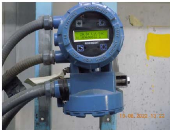
Fotografía 9. Caudal utilizado para Sistema de Riego Artificial (SRA) desde pozo P3 (LA-3), registrado el día 19-08-2022.
