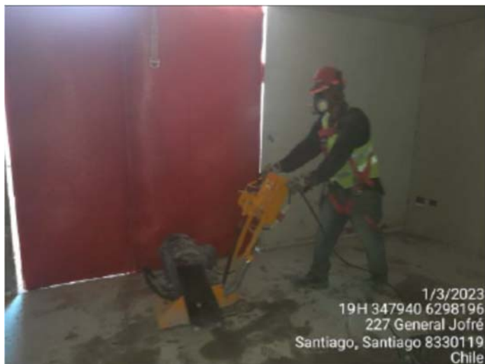
Figura 3. Pulidora de pisos con apantallamiento acústico implementado
