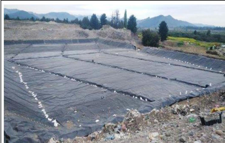
Fotografía 11. Impermeabilización basal de Celda 1 contenida en informe del titular remitido con fecha 17 de marzo de 2023.
