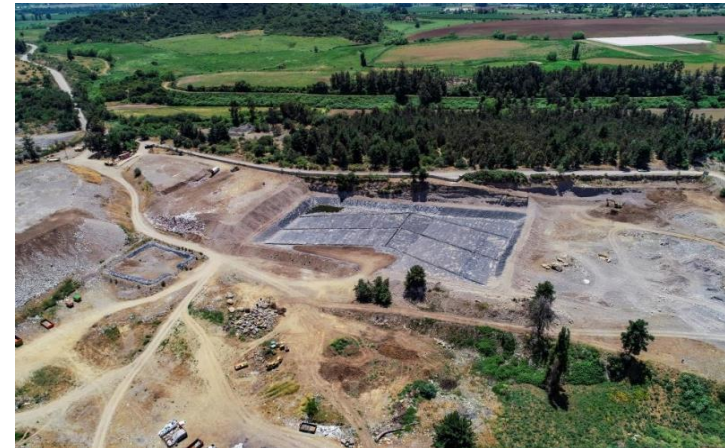
Fotografía 12. Impermeabilización basal de Celda 1 contenida en informe del titular remitido con fecha 17 de marzo de 2023.
