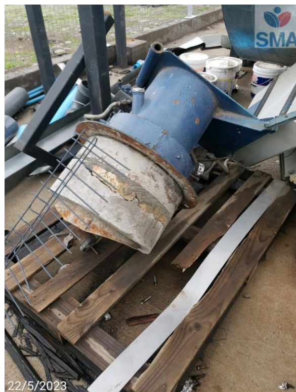
Foto 4 Quemador antiguo caldera exterior foto 4 (pruebas)
