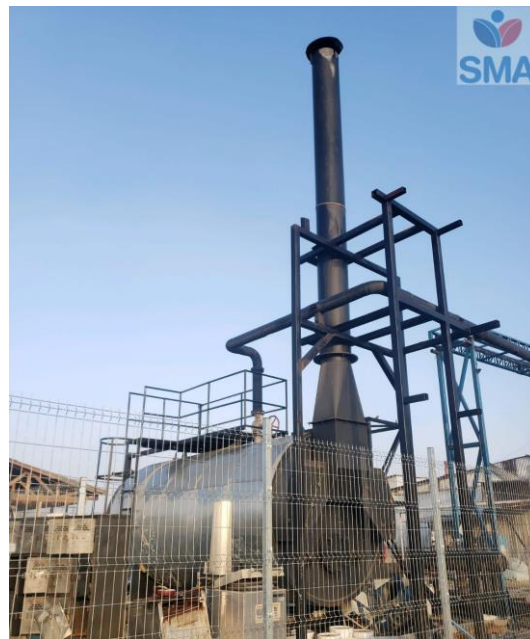
Foto 4 Caldera Exterior desconectada a combustible líquido.
