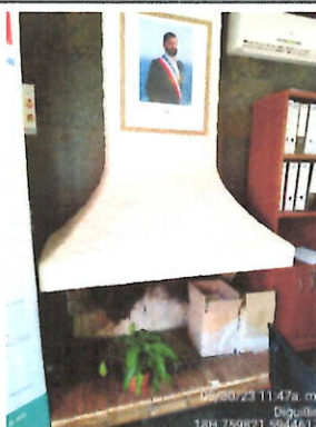
Equipo a leña, deshabilitada.
