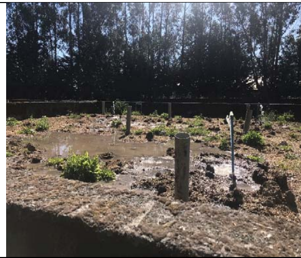
Fotografía N°3: Se aprecia la descarga de aguas servidas alimentando el lecho filtrante en donde se verifica que no existen boquillas de aspersión estando la tubería descargando mediante chorro directo sobre zona circundante
