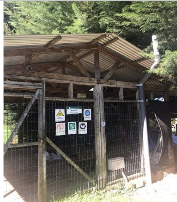
Fotografía N°1: Instalación asociada a la planta elevadora de aguas servidas (PEAS) de San Ramón, sin cierre perimetral, sistema de venteo de baja altura
