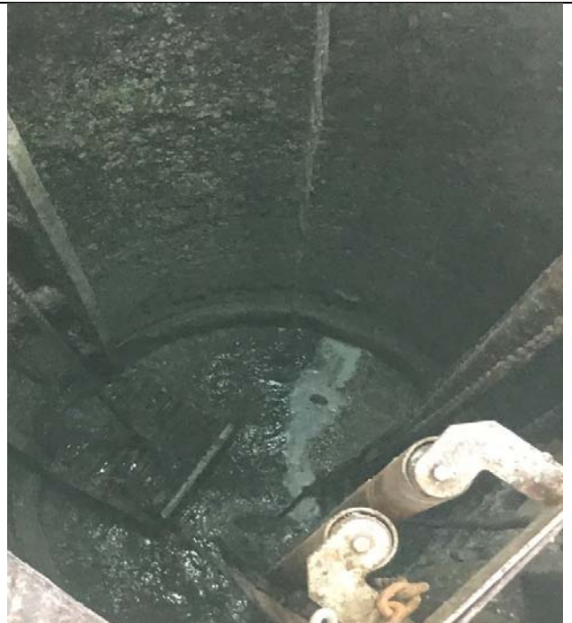
Fotografía N°2: Cámara de ingreso y elevación de aguas servidas asociado a la PEAS de la PTAS San Ramón, la cual se presenta abierta generando un punto de venteo de las aguas servidas crudas
