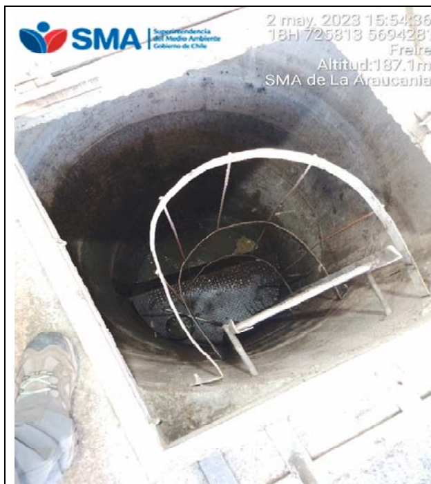
Fotografía N°1: Instalación sistema de reja fina implementada para retener residuos finos, reja de tipo manual y de limpieza manual operando abierta
