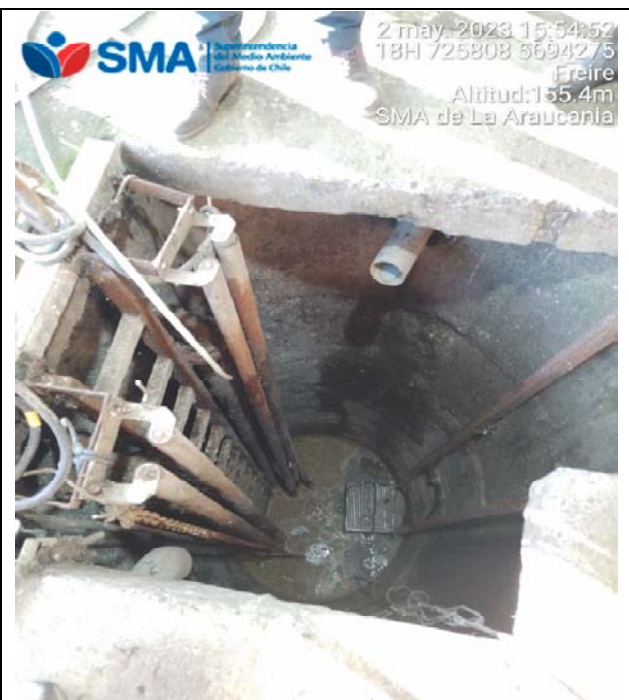
Fotografía N°2: Cámara de ingreso y elevación de aguas servidas asociado a la PEAS de la PTAS San Ramón, la cual se presenta abierta generando un punto de venteo de las aguas servidas crudas
