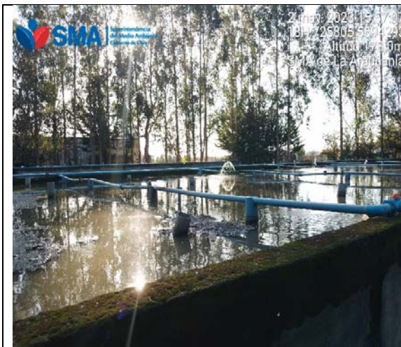
Fotografía N°5: Módulo 2 con apozamiento de aguas que generan deficiencias en la operación del proceso y malos olores por descomposición
