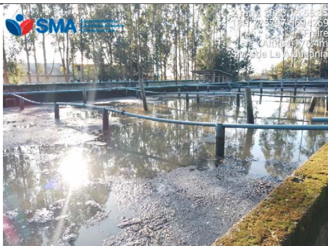
Fotografía N°4: Módulo 1 con apozamiento de aguas que generan deficiencias en la operación del proceso y malos olores por descomposición.
