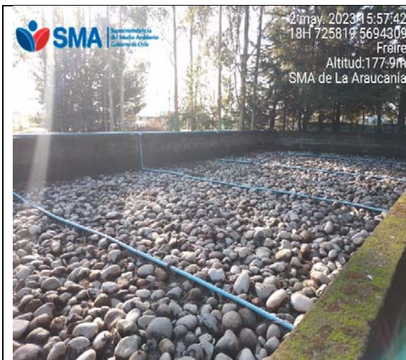
Fotografía N°3: Compartimento asociado al Módulo 1 que se encuentra en mantenimiento por cambio de empaque. Corresponde a un área de 200 metros cuadrados que no están operativos.
