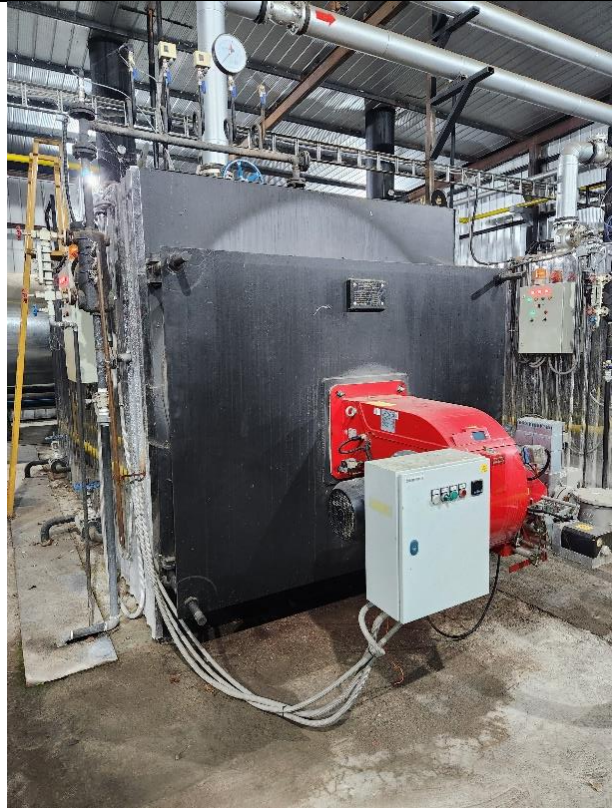
Fotografía 7: Caldera a gas N°3 en funcionamiento
