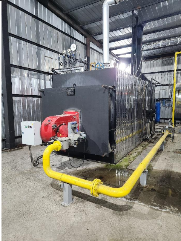
Fotografía 3: Caldera a gas N°1 en funcionamiento
