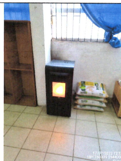
Segundo equipo a pellet, habilitado
