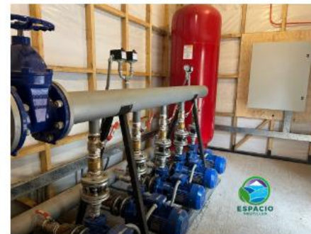
Sala de bombas agua
