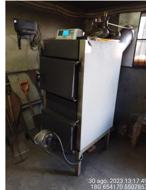
Fotografía 2 Caldera presente en la Unidad Fiscalizable "MADERAS DEL SUR LTDA"
