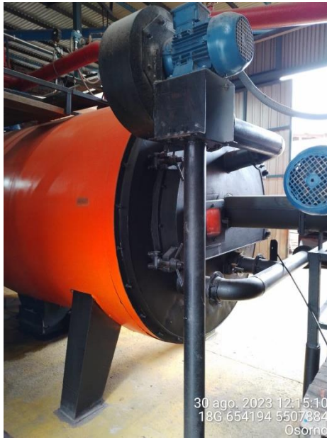
Fotografía 1 Caldera presente en la Unidad Fiscalizable "MADERAS DEL SUR LTDA"
