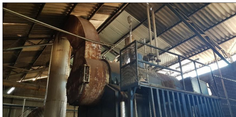
Fotografía 2. Caldera a leña código SSMAU – 116 constatada en la unidad fiscalizable Curtiembre Rufino Melero durante la inspección de fecha 11-04-2023.
