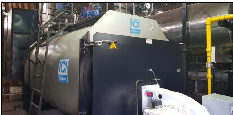
Fotografía 1. Fotografía de caldera a gas que opera en la unidad fiscalizable Curtiembre Rufino Melero, constatada en inspección de fecha 11-04-2023.
