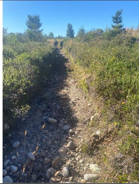
Imagen N°8: zanjas ejecutadas en lote 3-c que provienen desde el perímetro del proyecto. Fecha:30.01.2024
