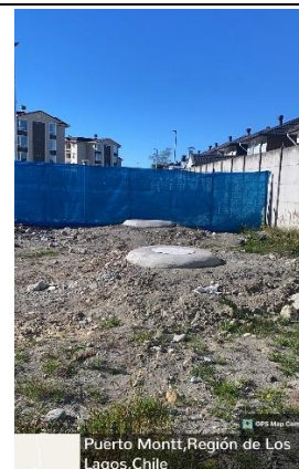
Imagen N°6: cámaras de inspección del proyecto de infiltración de las aguas lluvias. Fecha:30.01.2024
