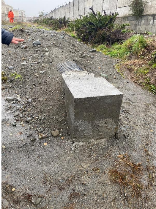
Imagen N°1: Colector de aguas lluvias, ubicado en lote 3-b-1, tapado con cemento por orden Municipal para evitar seguir descargando agua lluvias hacia estero La Paloma. Fecha: 22.09.2023
