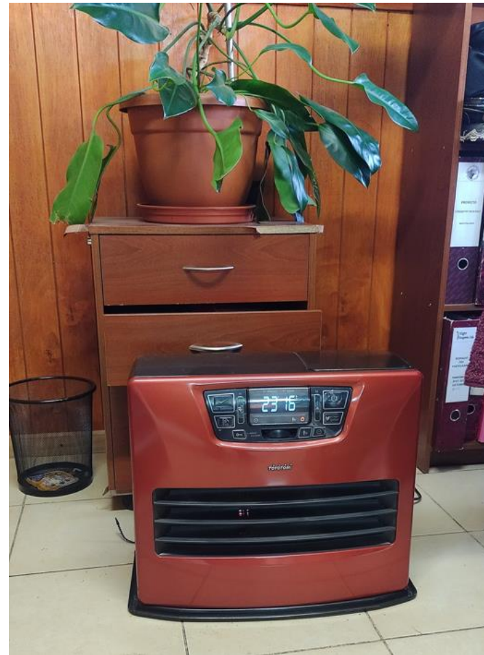
Fotografía N°4 Fecha: 23-05-2024 Descripción: Calefactor a parafina marca Toyotomi, instalado en reemplazo del calefactor a leña.
