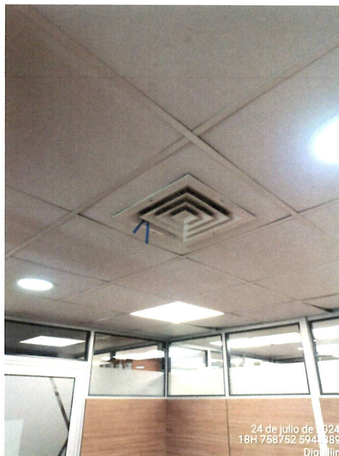
Uno de los tantos ductos de ventilación presentes en las instalaciones.
