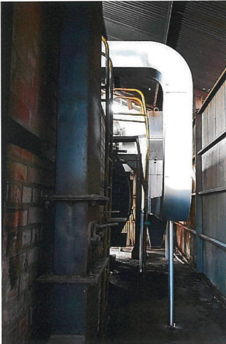
Vista lateral de línea habilitada de sistema de conducción de gases.
