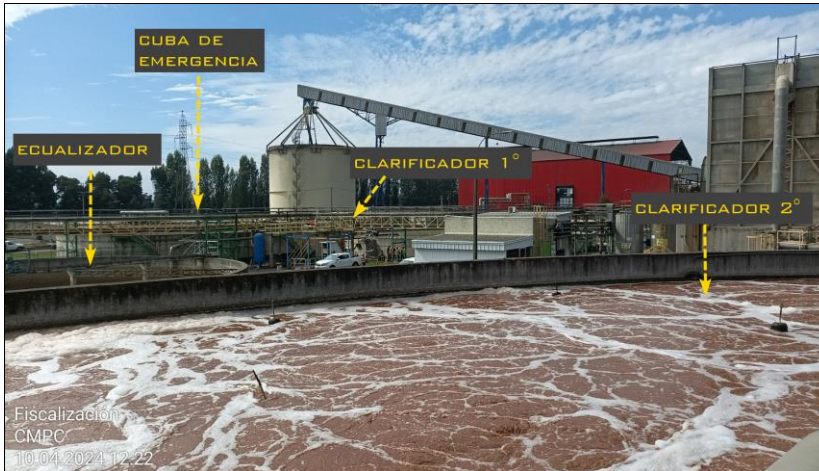
Fotografía 7. Vista general de la planta de tratamiento de RILes.
