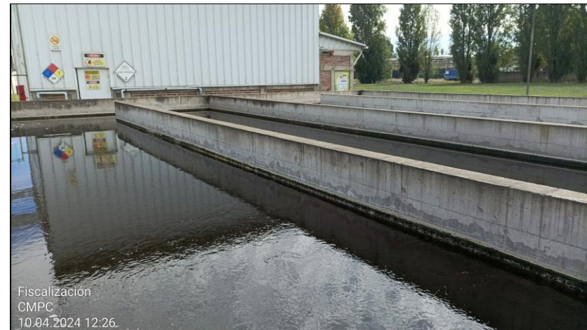
Fotografía 10. Cámara de contacto donde se realiza el proceso de cloración del efluente tratado.
