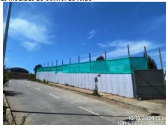
Pantalla acústica nor poniente
