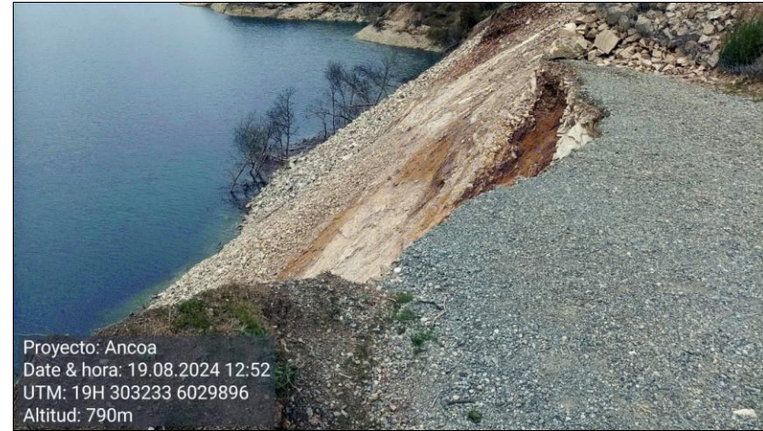
Fotografía 2. Fotografía del sector colapsado en la ruta L-39 captada al momento de la inspección.
