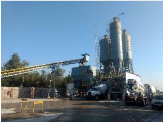
Planta de hormigón
